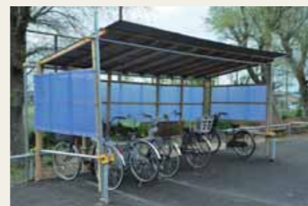
「雨にぬれて困る」との悩みを聞き、自転車置き場の屋根と囲いも8人が4日間かけて造った
